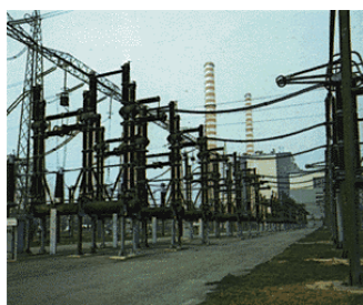
La centrale termoelettrica ENEL di Turbigo
